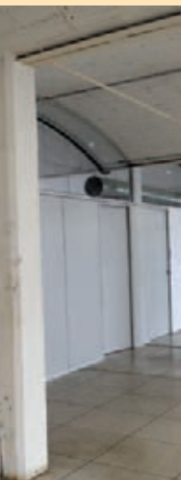
Escardívol: Las obras de este edificio están previstas para finalizar en diciembre
