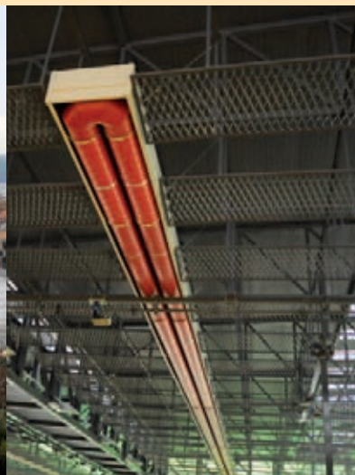
Calefacción pabellón La Llana: Una vez se disponga del suministro de gas, se comprobará que el sistema funcione correctamente
